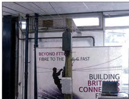
Die Freiluftmontage dieser G.fast-Versuchsanlage mit entsprechendem Drahtverhau lässt bezüglich Störstrahlung Schlimmes erahnen ...
